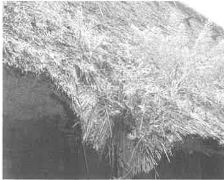
軒先部の茅が落下(旧野原家住宅)
