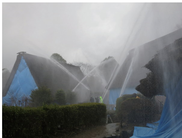
消火設備の放水試験
